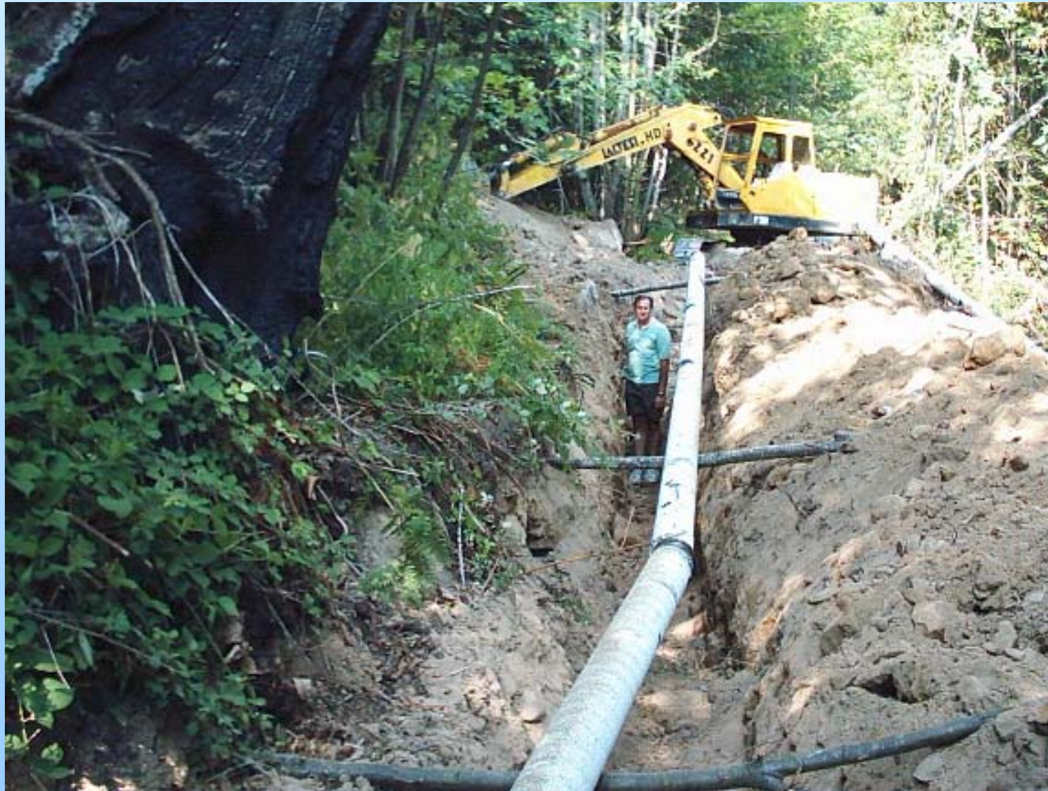
LA CONDOTTA FORZATA
